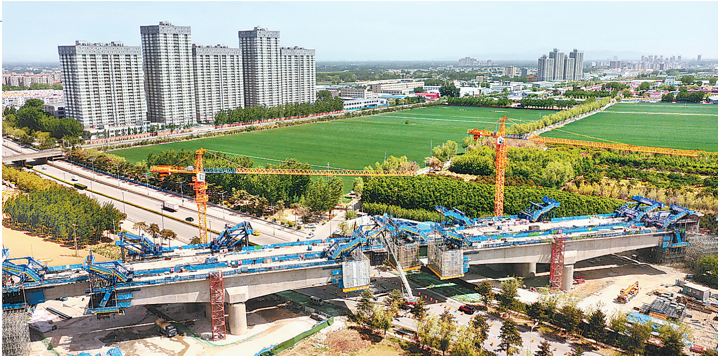
4月28日,京唐城际铁路跨燕郊环路特大桥建设工地塔吊林立,机器轰鸣,现场一派繁忙景象。(河北日报资料片) 河北日报通讯员 陈童摄
