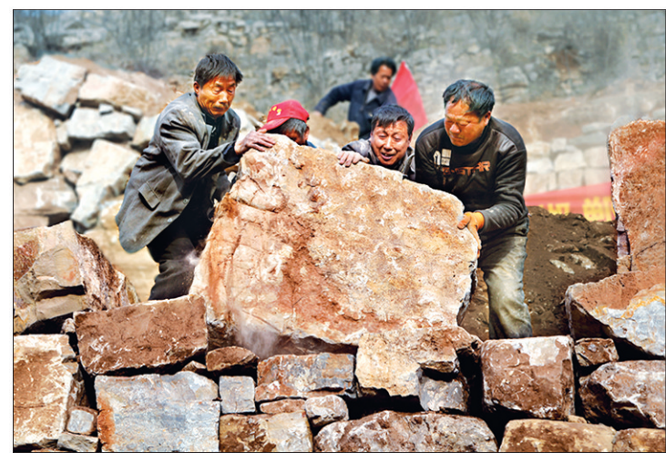
《太行山上新愚公》(组照之一) 作者:冯承庆 作品简介:涉县后池村村民发扬愚公移山精神,在峭壁上开凿出通山路、致富路、扶贫路。图为村民们在修山路。
