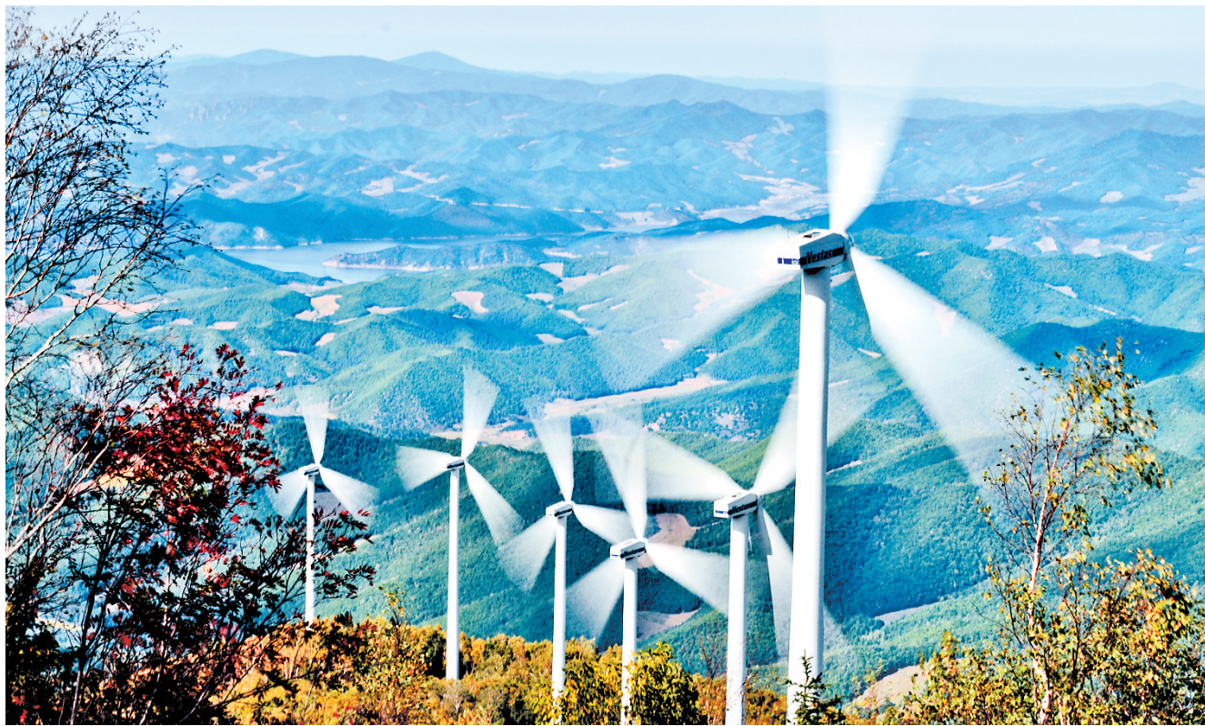
河北华电沽源风电有限公司风力发电场的风电机组。
