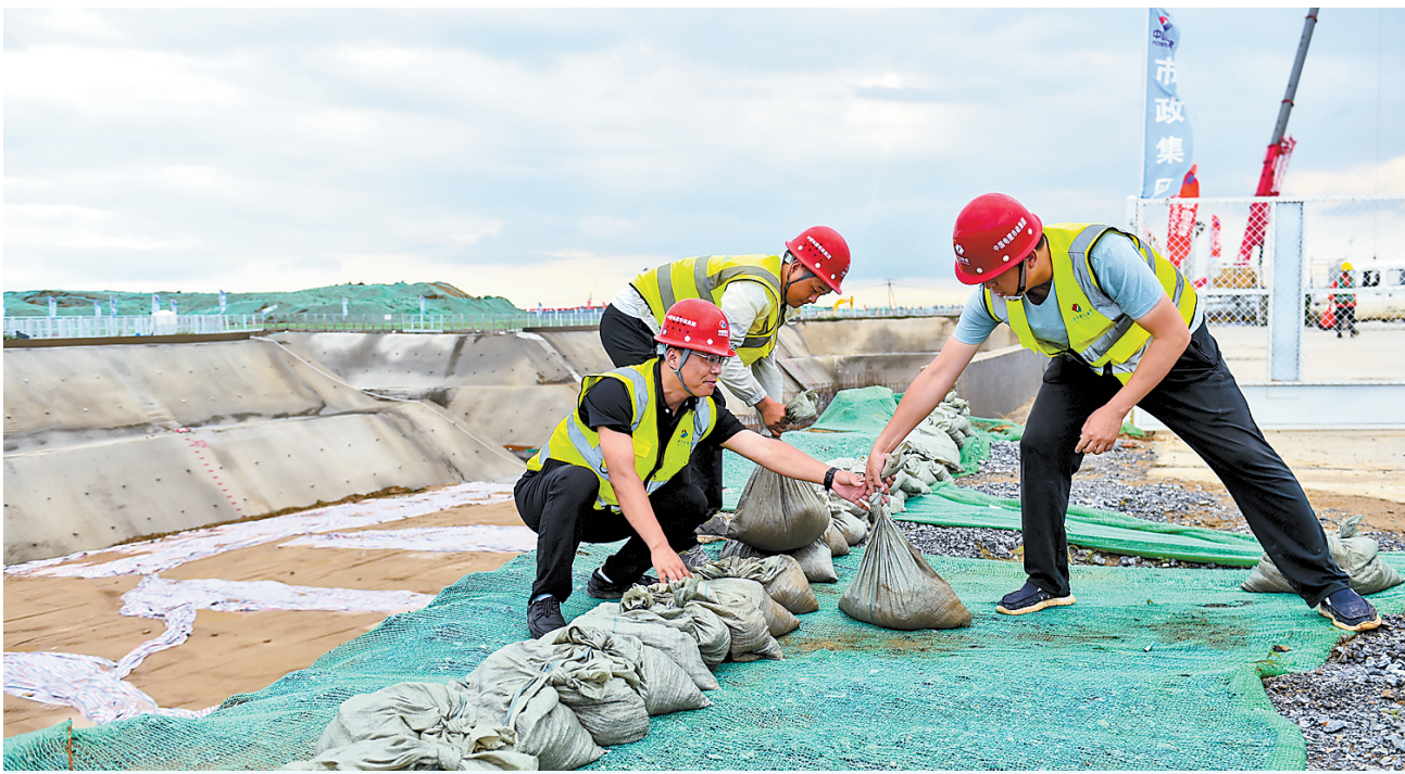
入汛以来,雄安新区严格落实各项防汛备汛措施,扎实做好应急排涝准备,全面排查风险隐患,制定重点在建项目防汛应急预案,确保安全度汛万无一失。图为雄安新区在建项目施工人员放置防汛沙袋。 河北日报记者 耿辉摄
