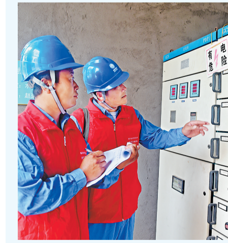
8月3日,国网临城县供电公司党员服务队队员在巡视临城水库配电设施,确保安全度汛。河北日报记者 赵永辉摄
