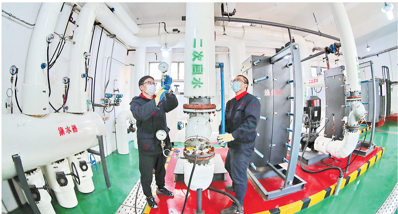
10月11日,秦皇岛市热力有限责任公司河东分公司的工作人员在检查热力站供热设施。秦皇岛市热力有限责任公司工作人员对供热小区内的供暖设施展开巡检与调试,确保安全供热,群众温暖过冬。河北日报通讯员 曹建雄摄
