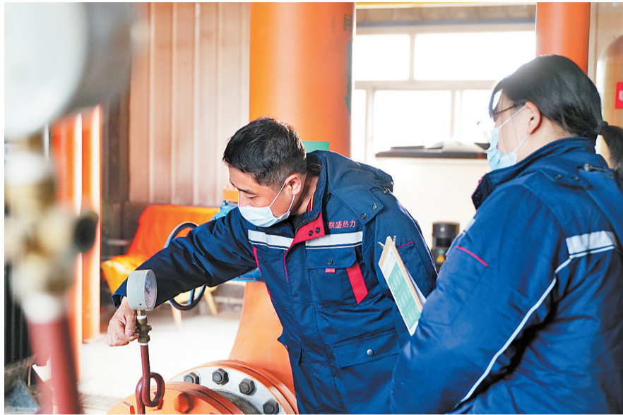
11月3日,在安新县凯胜佳苑小区燃气锅炉房,安新县寰慧凯盛热力公司技术人员对锅炉燃气表、循环泵压力表等关键环节进行检查。河北日报记者 李佳泽摄
