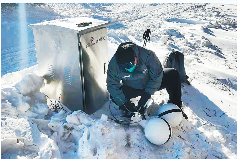
联通通信保障人员在测试赛前进行无线设备调测工作。
