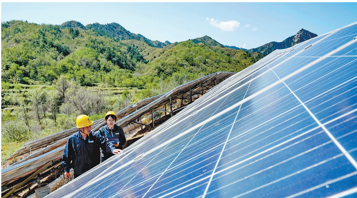
9月24日，国网平山县供电公司工人在平山县营里乡桃园10千伏储能站光伏发电板区巡查线路。
