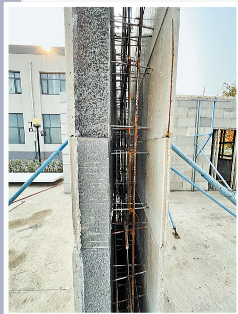
建造装配式住房用的混凝土模块剖面。河北日报记者 魏雨摄
