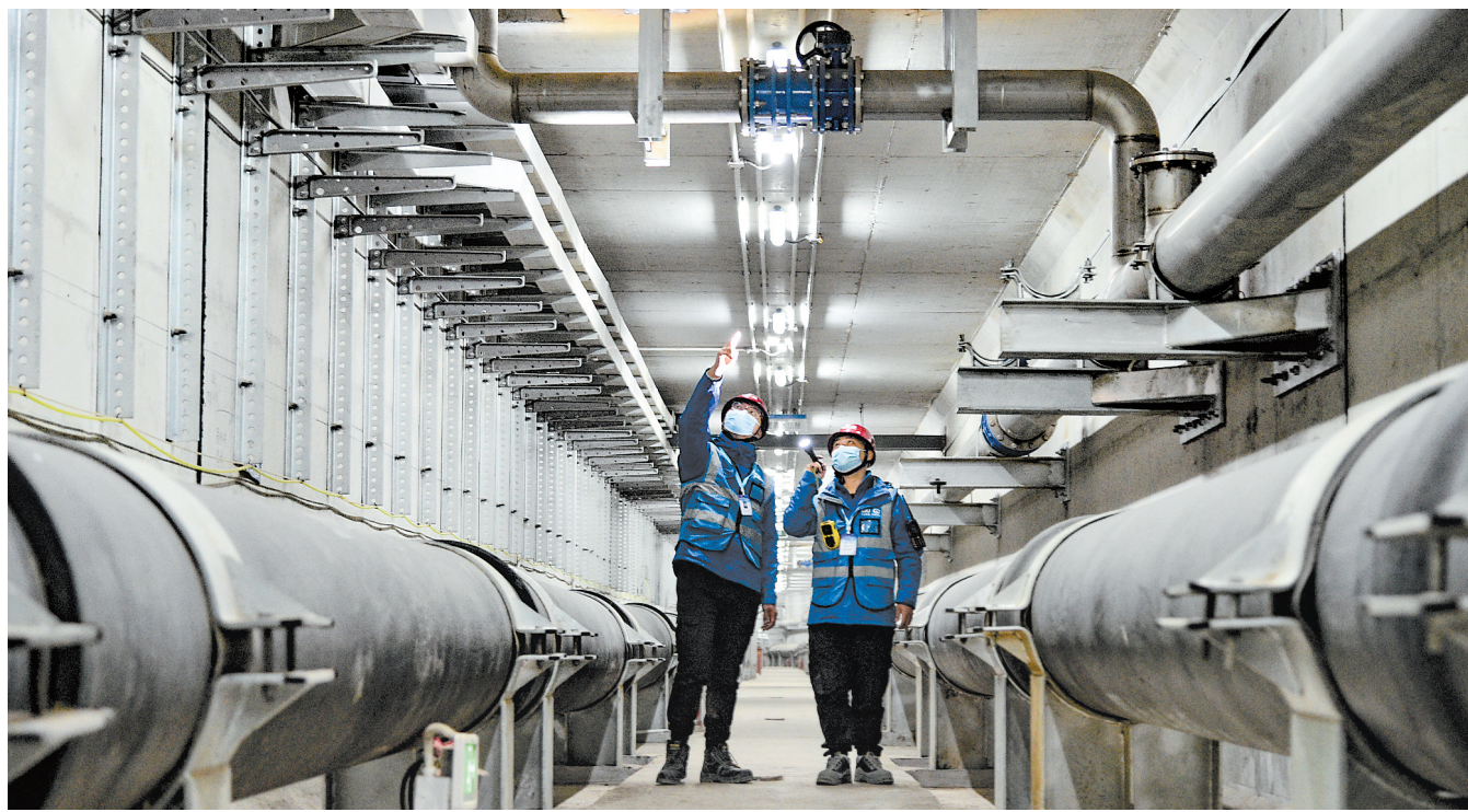
雄安新区容东片区综合管廊运维巡检组工作人员正在巡检。目前，雄安新区综合管廊单舱投运已达100公里。
