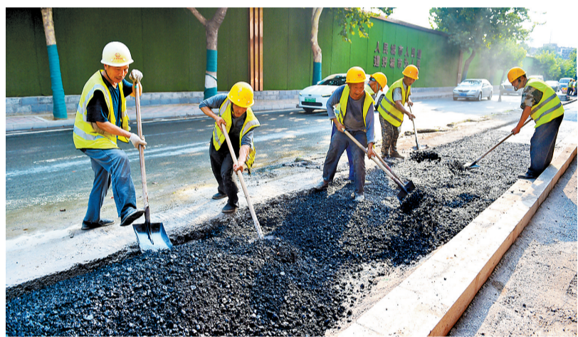
▲9月10日,在石家庄市维明大街与南二环连通工程现场,工人正在进行沥青摊铺作业。 河北日报记者 赵永辉摄
