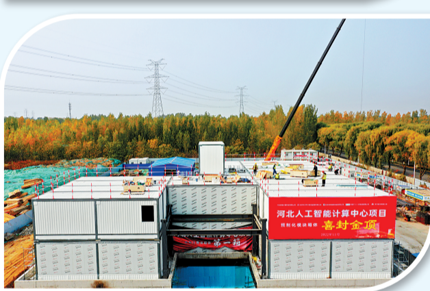
上图:从空中俯瞰正在建设中的润泽国际信息港。 河北日报通讯员 陈童摄 中图:在机科股份河北分公司生产车间内,工作人员正在调试定制款AGV机器人产品。 河北日报通讯员 沈营营摄 下图:11月15日,在河北人工智能计算中心项目一期现场,两层的数据中心楼已经拔地而起。 河北日报通讯员 杨雨川摄
