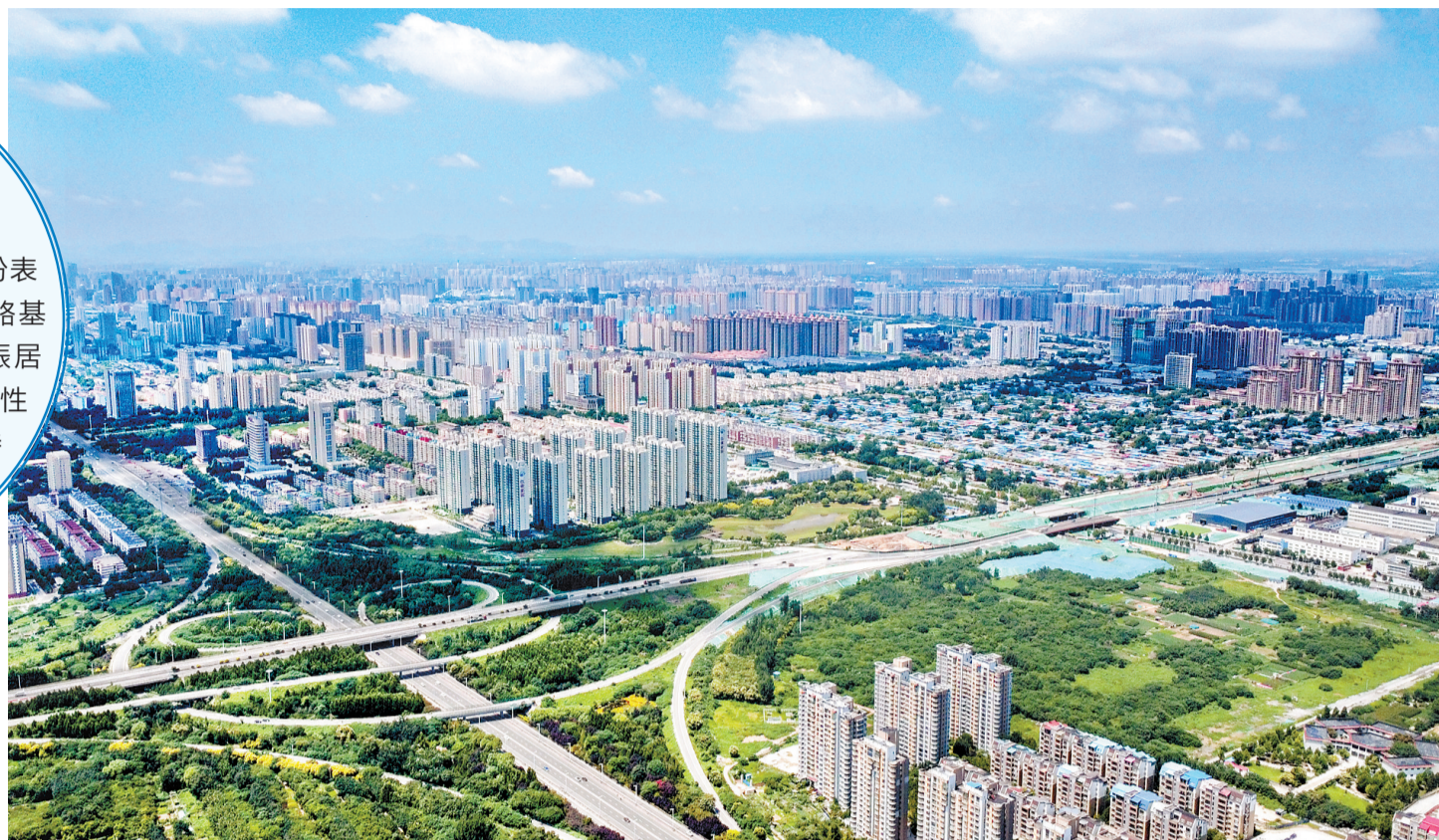
2022年7月28日,石家庄市复兴大街市政化改造项目(裕华路至和平路)现场,施工人员正在加紧进行各项工程施工。(本报资料片)
