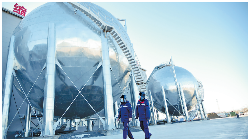
张北县百兆瓦先进压缩空气储能国家示范项目运维人员从球状蓄冷、蓄热罐旁走过。
