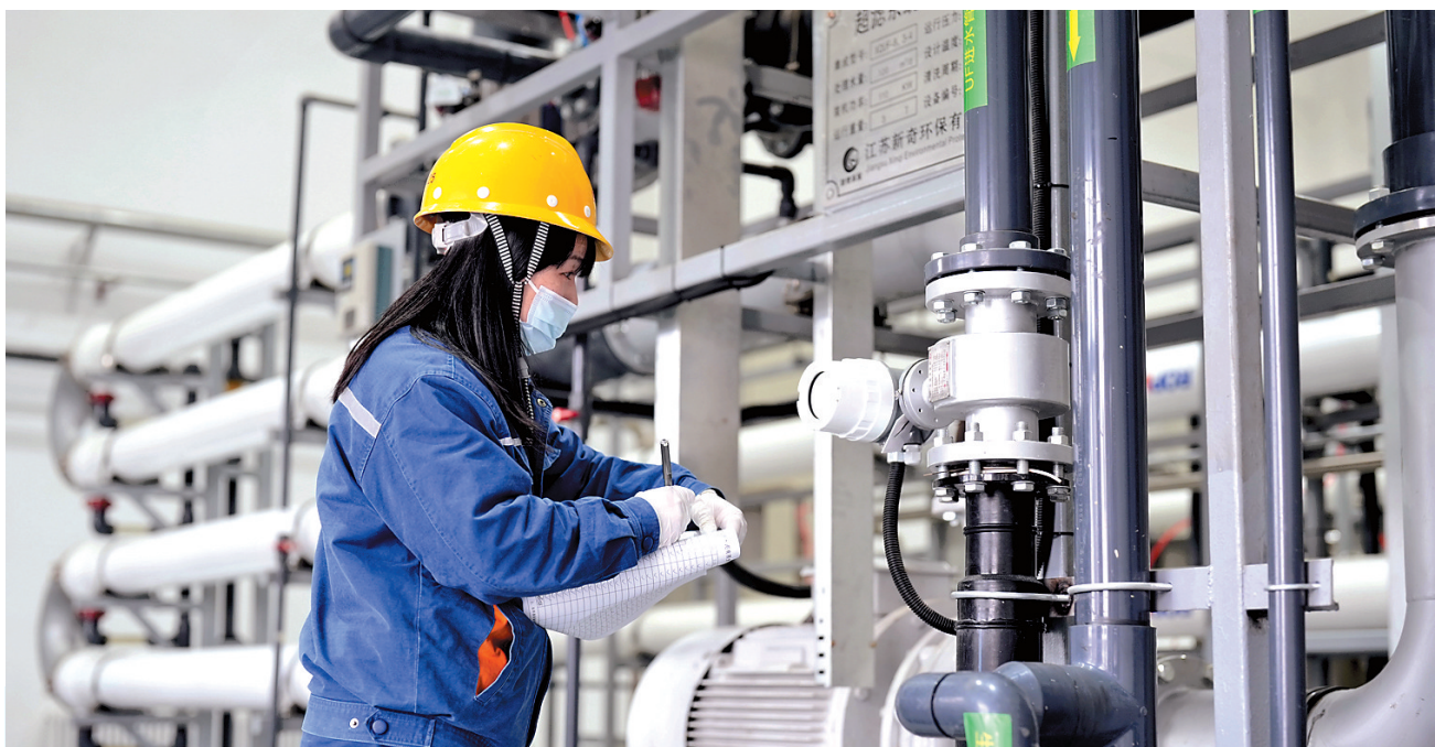
4月13日,工作人员在唐山冀东启新水泥有限责任公司渗液处理站内记录设备运转情况。该处理站可将生活垃圾产生的渗滤液经处理后转化为工业用水。近年来,该公司加快绿色发展、转型升级步伐,建设水泥窑协同处置综合固废及余热发电循环产业项目,并于2022年10月实现投产运行。 新华社记者 牟宇 摄
