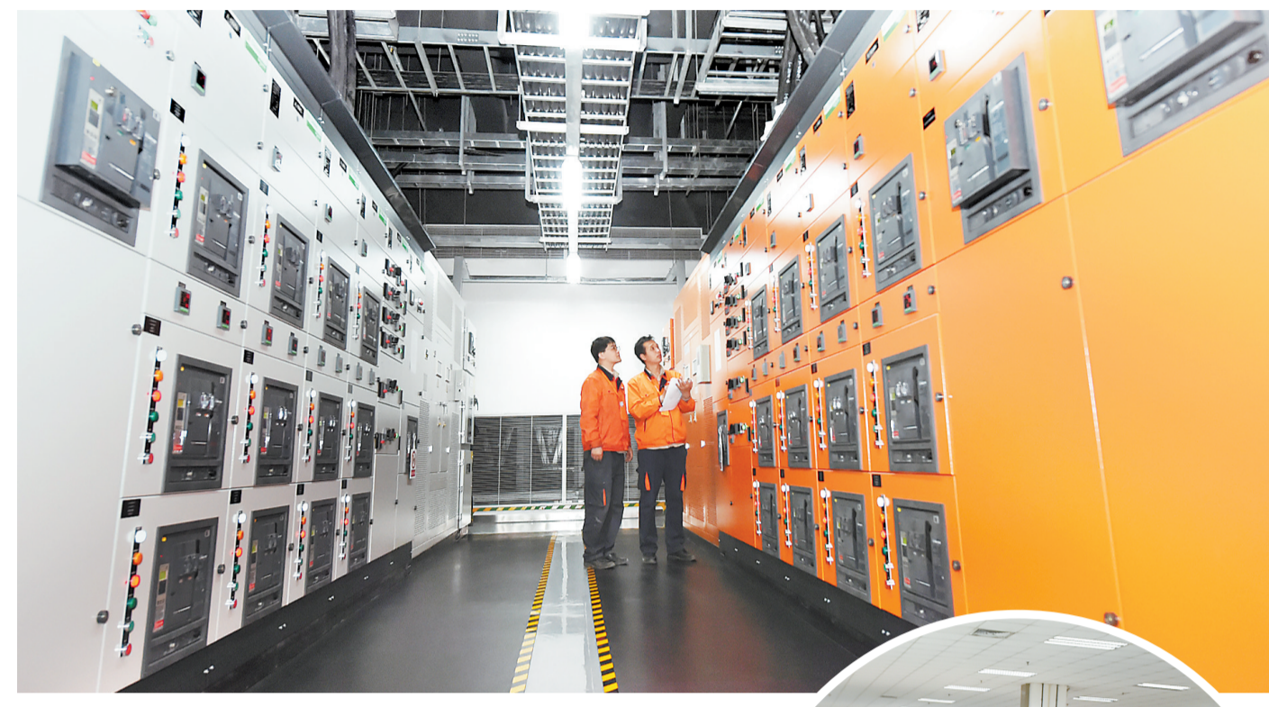
▲4月26日,在正定高新区常山云数据中心,工作人员对设备运行情况进行巡检。河北日报记者 史晟全摄
