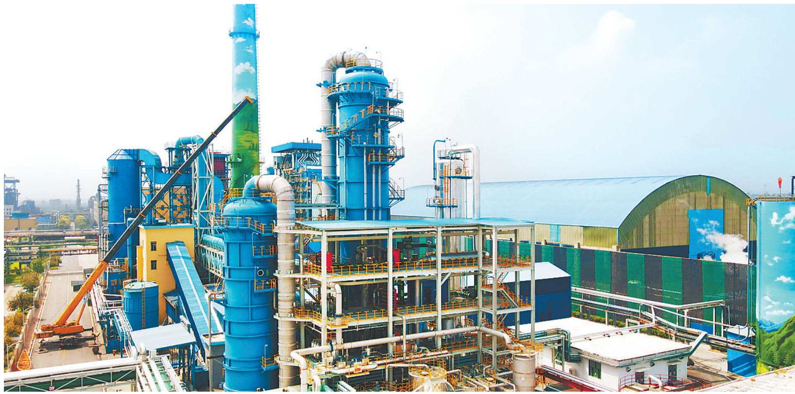
▲8月21日拍摄的河北建滔20万吨/年碳捕集与综合利用装置。 河北日报记者 赵永辉摄
