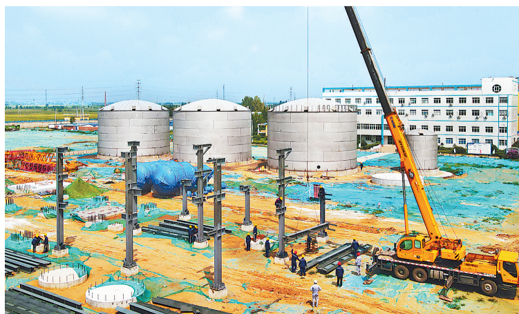
8月21日,施工人员在河北建滔碳捕集与综合利用年产80万吨醋酸项目现场施工。 河北日报记者 赵永辉摄
