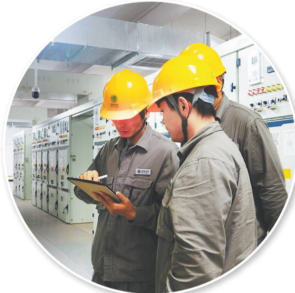
10月12日,石家庄辛集110千伏天官营变电站顺利投运,为区域电网迎峰度冬增添新动能。图为工作人员正在开展投运前的准备工作。 纪 冉摄
