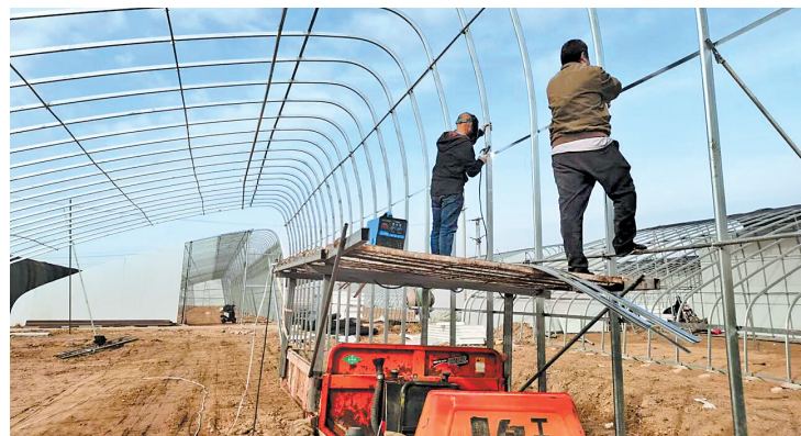
11月3日，宋王务村村民们在给新建温室大棚焊接钢架。河北日报记者 周禹佳摄
