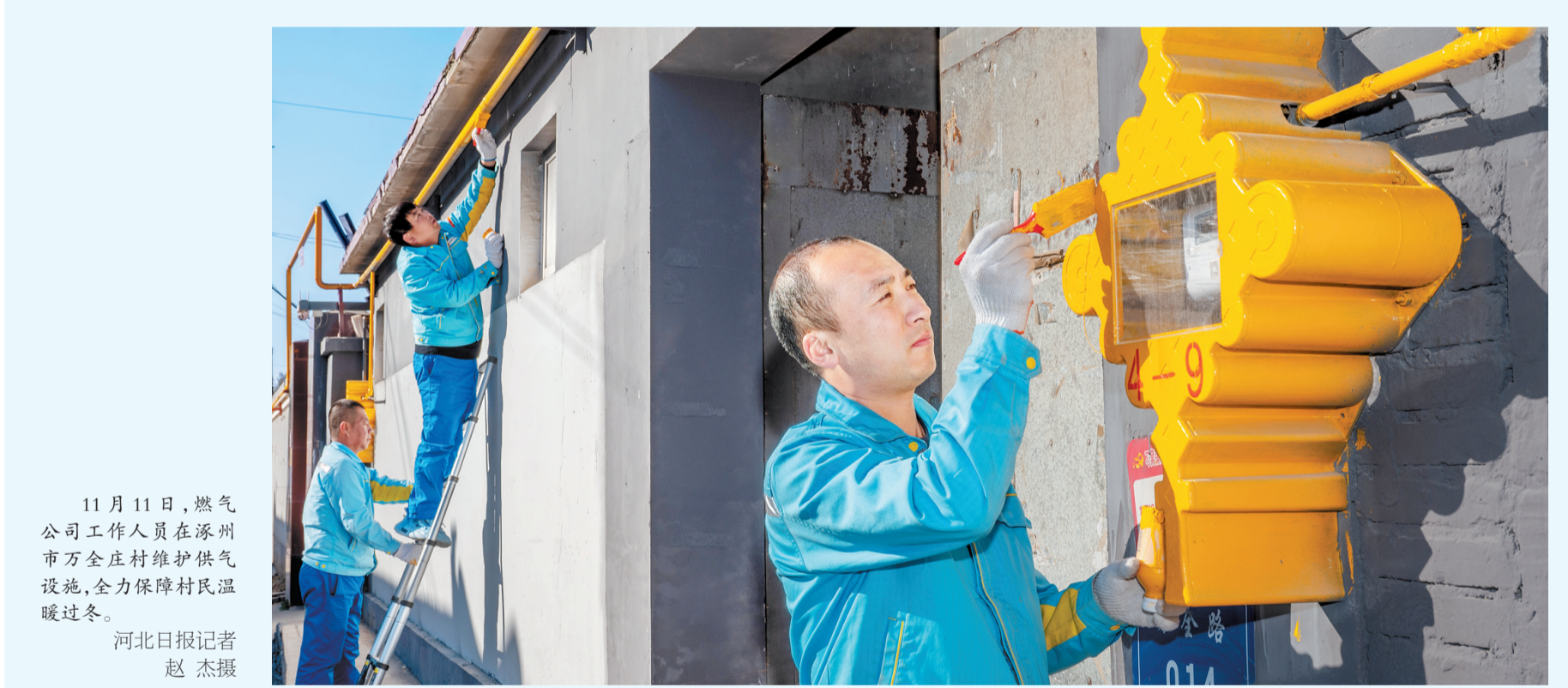
11月11日,燃气公司工作人员在涿州市万全庄村维护供气设施,全力保障村民温暖过冬。 河北日报记者 赵杰摄
