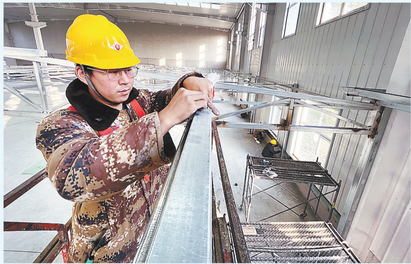
11月20日,在第六镜科技集团智能传感高端装备示范生产基地现场,工人在安装照明设备。
