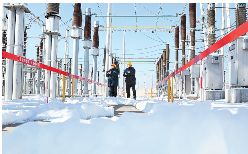
12月16日，国网石家庄供电公司工作人员在巡视220千伏韩通变电站电网设备。为积极应对寒潮降温天气，该公司强化对电网设备的巡视和监测，全力保障电力供应和群众温暖过冬。 河北日报记者 史晟全摄
