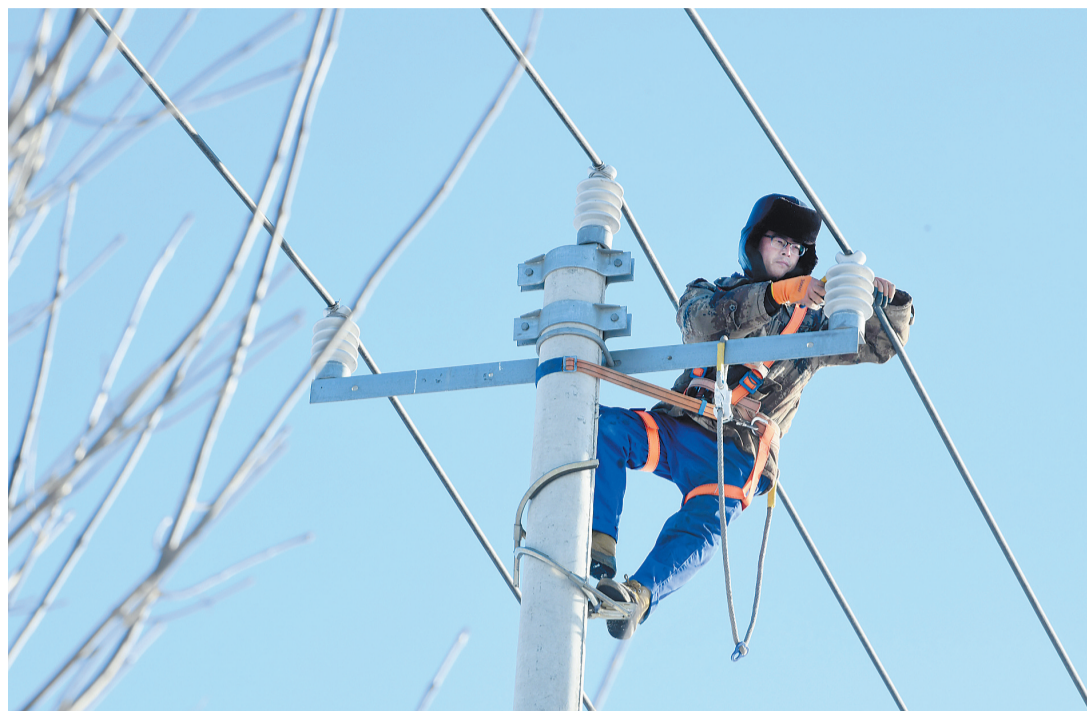
12月17日,新乐市供电公司员工在新乐市经济开发区进行线路施工。新乐市供电公司多措并举,保障线路安全稳定运行。河北日报通讯员 贾敏杰摄
