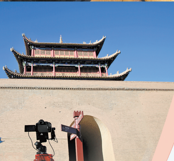
1月29日，嘉峪关丝路(长城)文化研究院文化遗产监测中心工作人员高商，正在对柔远楼城台裂缝进行定期监测。 嘉峪关丝路(长城)文化研究院供图
