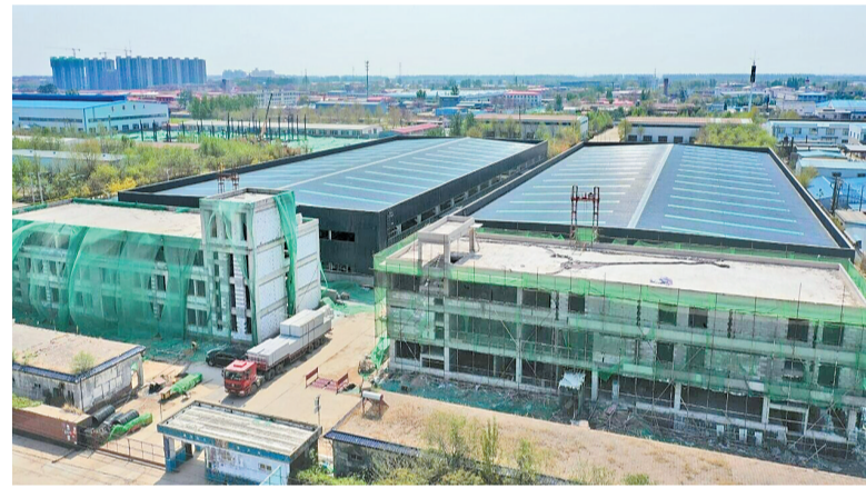
4月9日，位于邱县经济开发区的河北鑫芳新能源科技有限公司新建项目施工现场。
